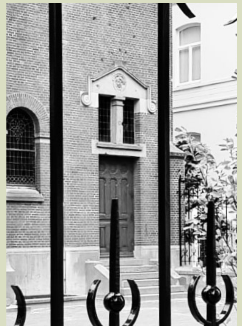
Kogelgaten in de gevel.
